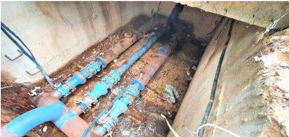
Φωτογραφία 1 : Άποψη του Α/Σ Ασκληπιού Ι
