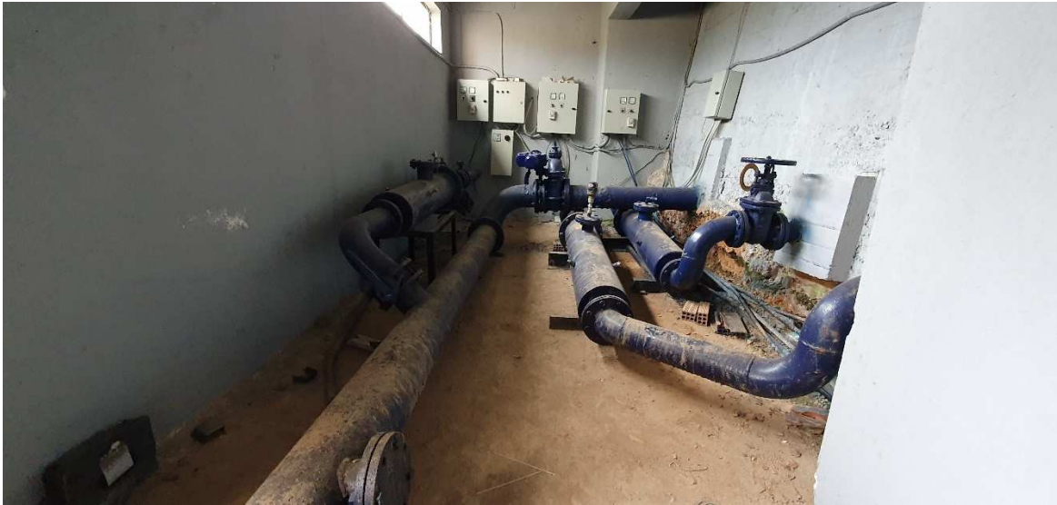
Φωτογραφία 10 : Άποψη του Α/Σ Δεξαμενής Αγίου Δημητρίου
