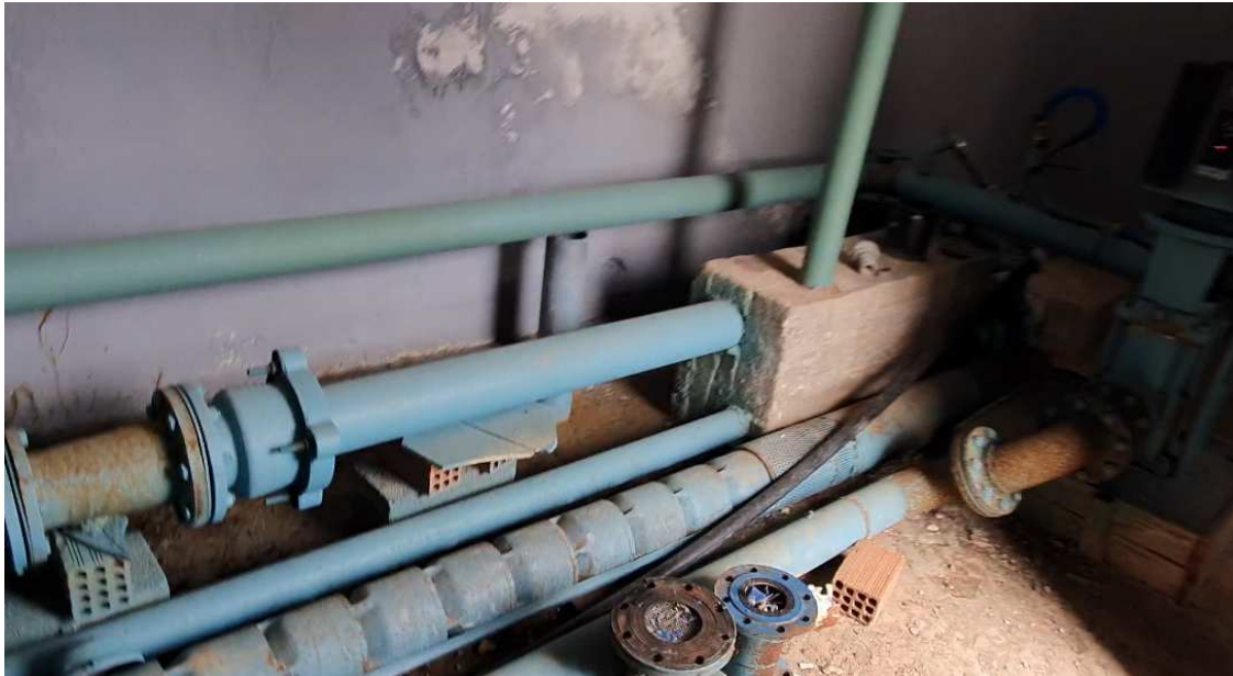
Φωτογραφία 9 : Άποψη του Α/Σ Δεξαμενής Κρουονερίου
