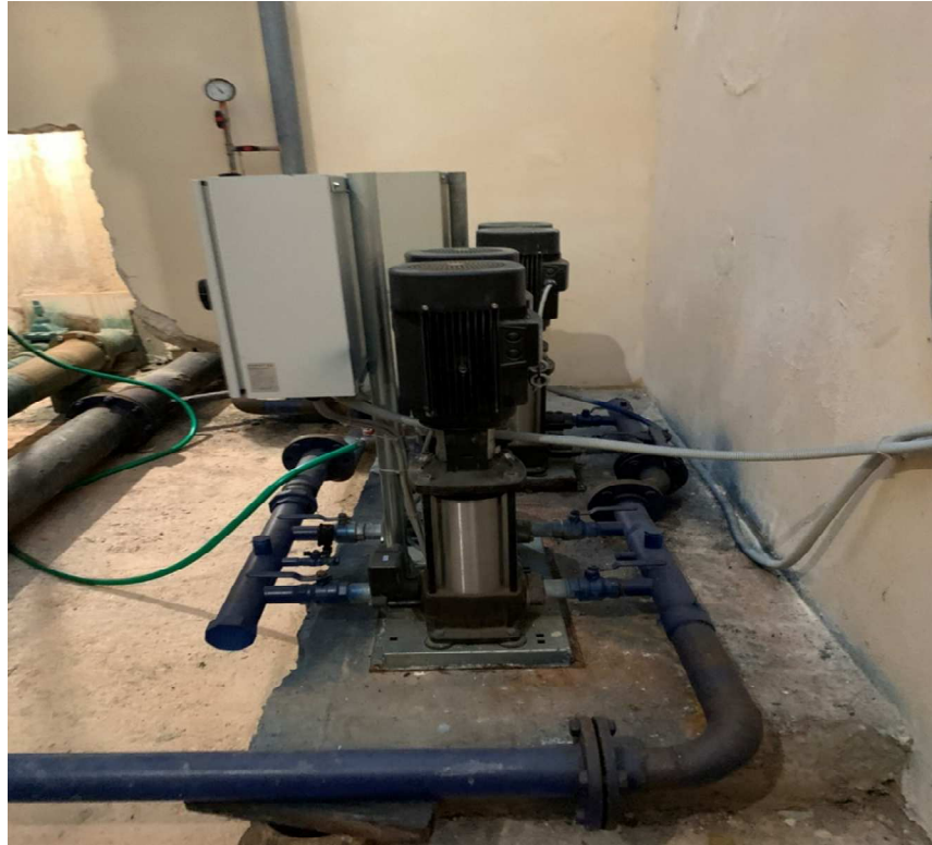
Φωτογραφία 14 : Άποψη του Α/Σ Δεξαμενής Αγίων Πάντων
