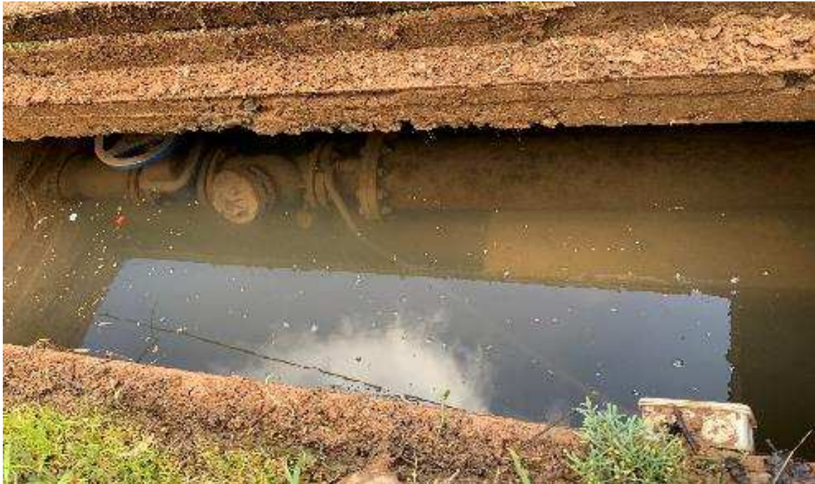
Φωτογραφία 6 : Άποψη του Α/Σ Σουλίου II
