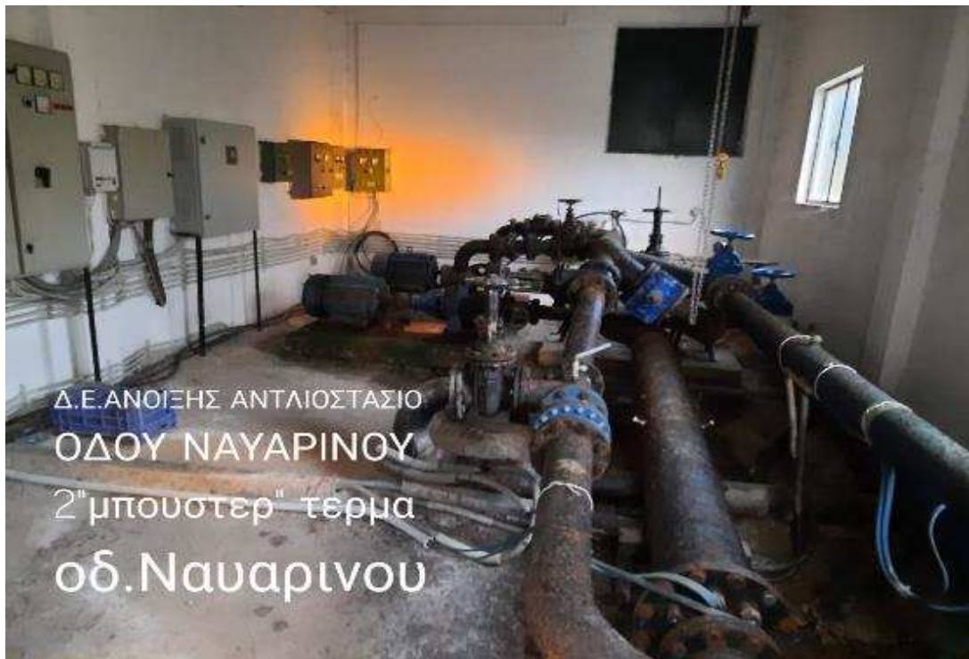
Φωτογραφία 4 : Άποψη του A/Σ Ναυαρίνου
