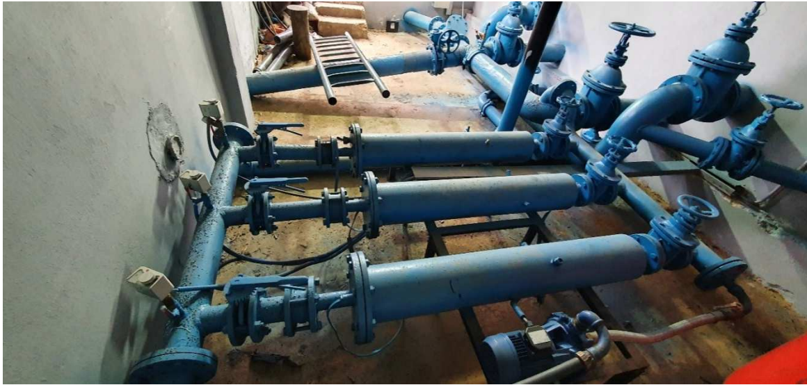
Φωτογραφία 11 : Άποψη του Α/Σ Δεξαμενής Αγίου Δημητρίου
