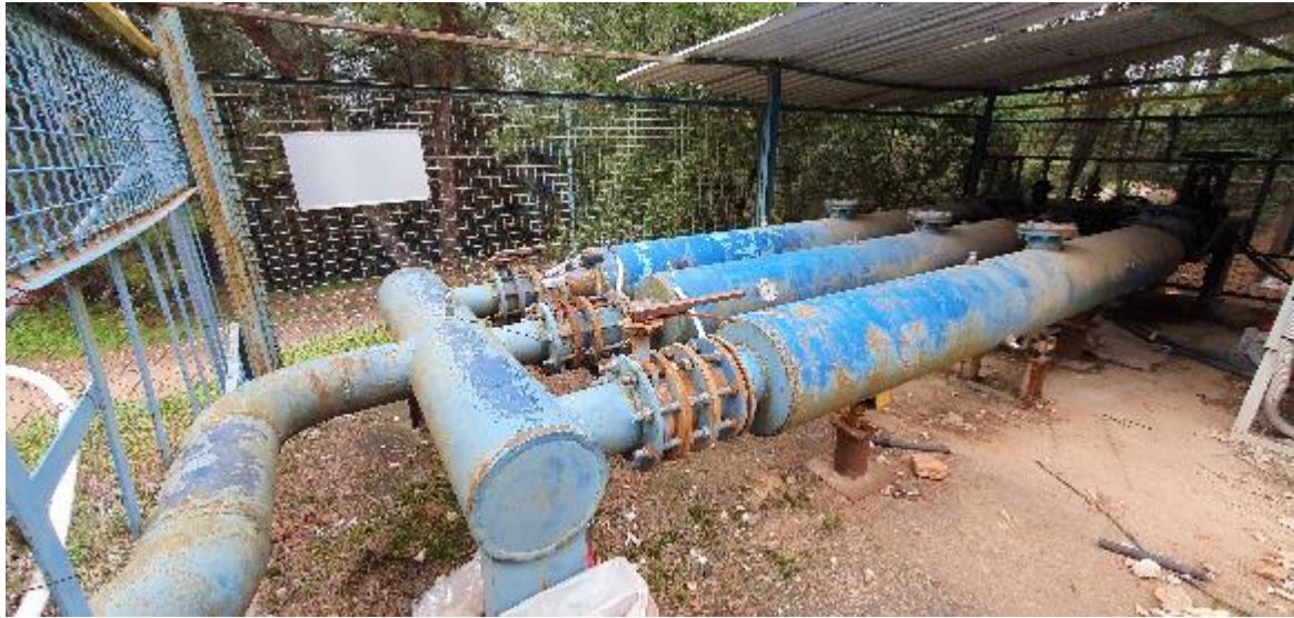
Φωτογραφία 7 : Άποψη του Α/Σ 3 Πεύκα Ι
