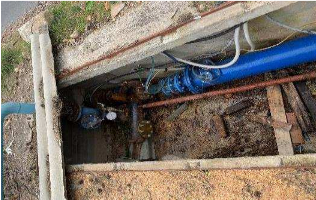
Φωτογραφία 2 : Άποψη του Α/Σ Ασκληπιού II
