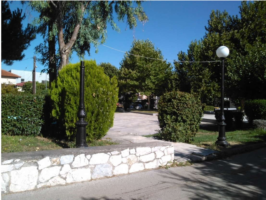
ΦΩΤΟΓΡΑΦΙΑ 8 (Είδη Υπομήματος Γ3, Άρθρο 8) ΦΩΤΙΣΤΙΚΟ ΣΩΜΑ ΚΕΦΑΛΗΣ ΤΥΠΟΥ ΜΠΑΛΑΣ (ΠΛΑΤΕΙΑ ΔΗΜΟΤΙΚΗΣ ΕΝΟΤΗΤΑΣ ΡΟΔΟΠΟΛΗΣ)
