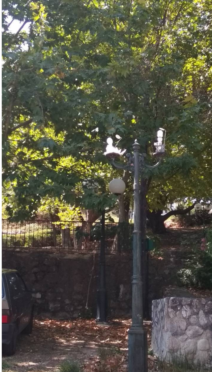
ΦΩΤΟΓΡΑΦΙΑ 14 (Είδη Υπομήματος Γ3, Άρθρο 9) ΚΕΦΑΛΗ ΜΕ ΒΑΣΗ ΣΤΗΡΙΞΗΣ, ΔΥΟ ΒΡΑΧΙΟΝΕΣ ΚΑΙ ΔΥΟ (2) ΦΩΤΙΣΤΙΚΑ ΣΩΜΑΤΑ Φ300 ΜΕ ΛΑΜΠΗΤΗΡΕΣ LED ( ΟΔΟΣ ΜΕΓΑΛΟΥ ΑΛΕΞΑΝΔΡΟΥ ΔΗΜΟΤΙΚΗ ΕΝΟΤΗΤΑ ΣΤΑΜΑΤΑΣ )
