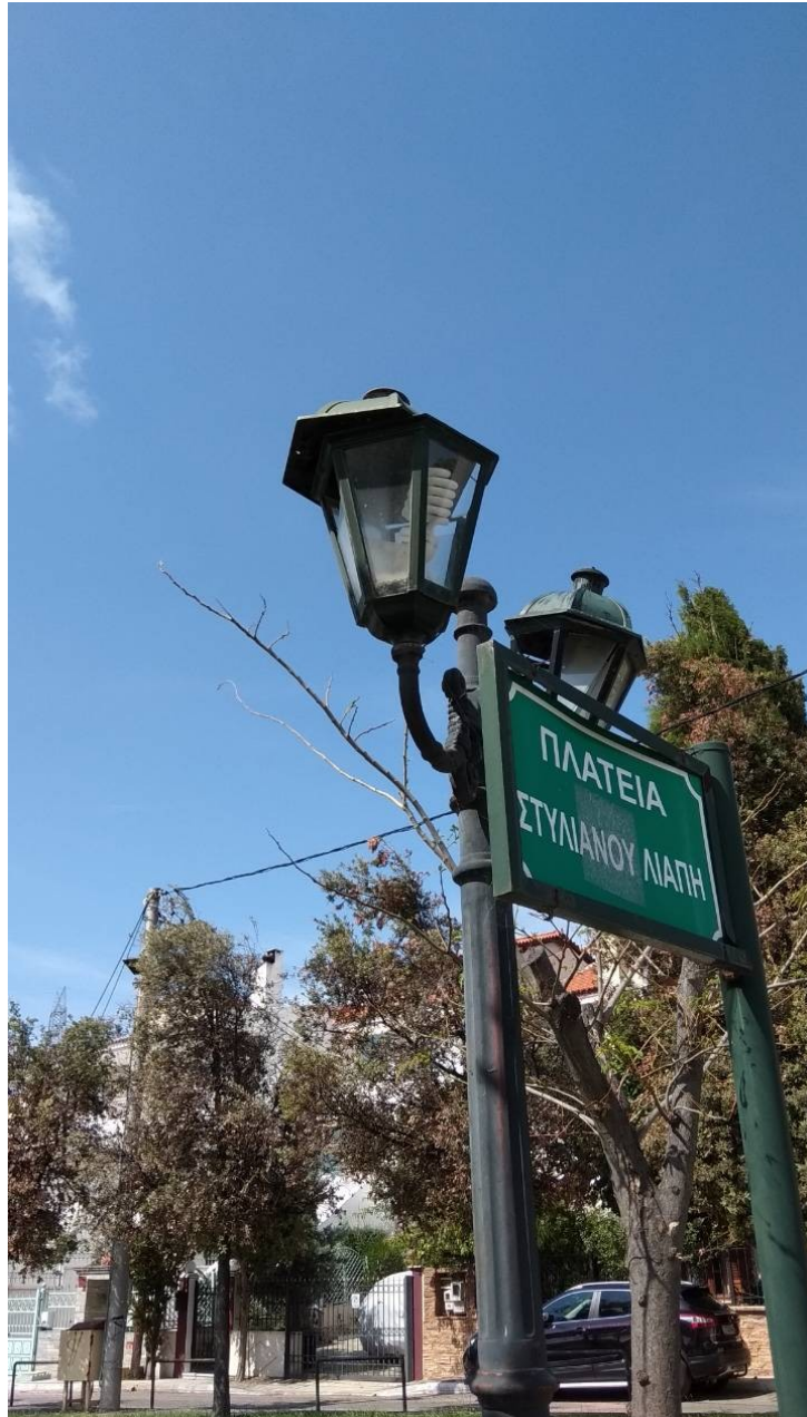
ΦΩΤΟΓΡΑΦΙΑ 5 (Είδη Υποτήματος Γ3, Άρθρο 5) ΚΕΦΑΛΗ ΜΕ ΒΑΣΗ ΣΤΗΡΙΞΗΣ, ΔΥΟ ΒΡΑΧΙΟΝΕΣ ΚΑΙ ΔΥΟ ΦΩΤΙΣΤΙΚΑ ΤΥΠΟΥ «ΠΑΡΑΔΟΣΙΑΚΟ ΦΑΝΑΡΙ», ΜΕΣΑΙΟ, ΜΕ ΛΑΜΠΤΗΡΕΣ LED (ΠΛΑΤΕΙΑ ΛΙΑΠΗ ΔΗΜΟΤΙΚΗ ΕΝΟΤΗΤΑ ΚΡΥΟΝΕΡΙΟΥ)
